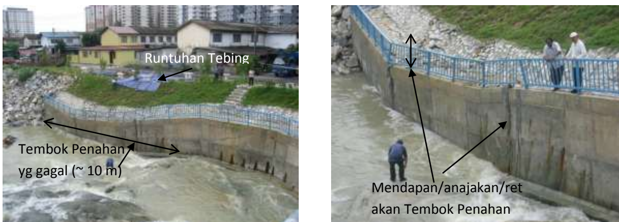
Rajah A: Kegagalan Tembok Penahan di Sungai Kayu Ara, Petaling Pada Hujung Tahun 2009
