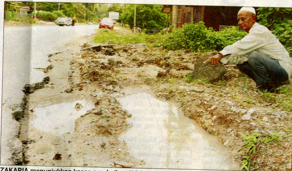
ZAKARIA menunjukkan kesan pembaikan tidak sempurna paip pecah yang didakwa dijalankan oleh kontraktor di Kampung Mendom, Lenggeng semalam.
